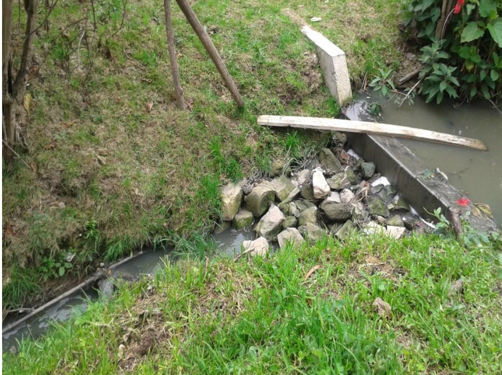
Fotografía 7. Estructuras de disipación dentro de cauce de la quebrada El Chuscal.
