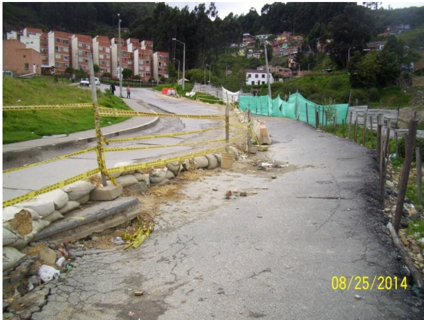
Fotografía 3. Estado de la avenida carrera 18 Este, objeto de intervención por parte de IDU.
